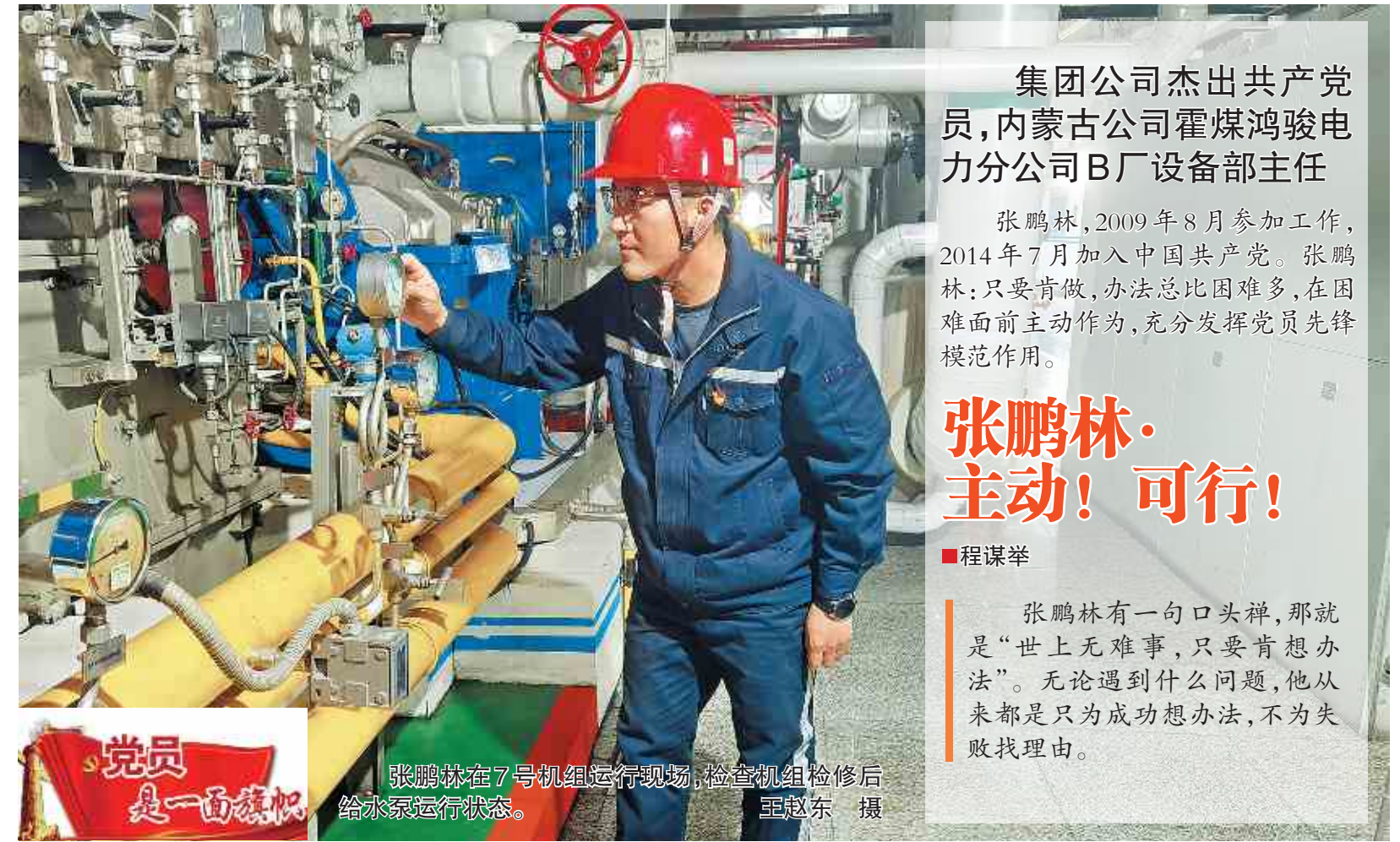
张鹏林在7号机组运行现场,指导机组检修后给水泵运行状态。
