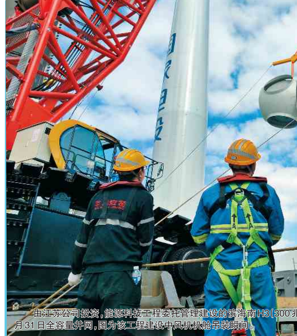
由江苏公司投资,能源科技工程受托管理建设的滨海南H3(300兆瓦)海上风电项目已于2020年12月31日全容量并网,能源科技工程建设中风机机舱吊装画面。
