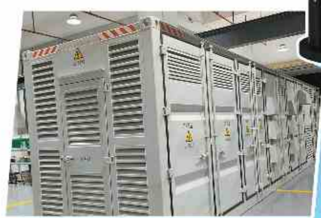
▲135千瓦时 500千瓦飞轮储能电池。 ▲MW级飞轮储能集装箱系统。
