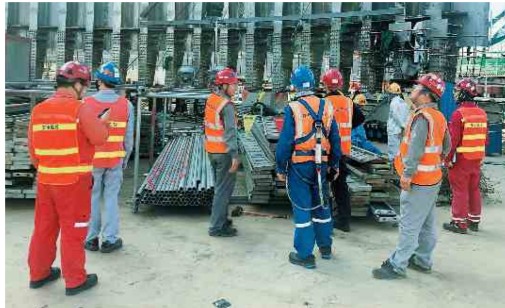
▲今年第6号台风“烟花”来势汹汹,连日来,集团公司相应区域单位提早部署、周密防范,从人员、物资、设备等多方面采取有力措施,全力做好防御台风的各项准备工作,筑牢防汛安全屏障。7月27日上午,在山东荣成,国核示范工作人员组织承包商检查模块抗风加固措施,确保设备的安全。张翠翠 摄
