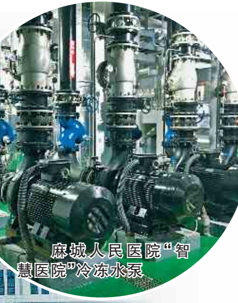
麻城人民医院“智慧医院”冷冻水系统
